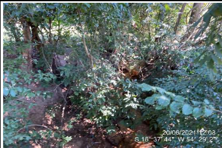
FOTO 16 - LOCAL DE LANÇAMENTO DA DRENAGEM PLUVIAL
